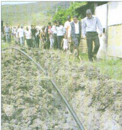
Xavier-Luc Duval (en avant plan) a constaté de visu l'avancement des travaux hier lors de sa visite à Cité La Cure
